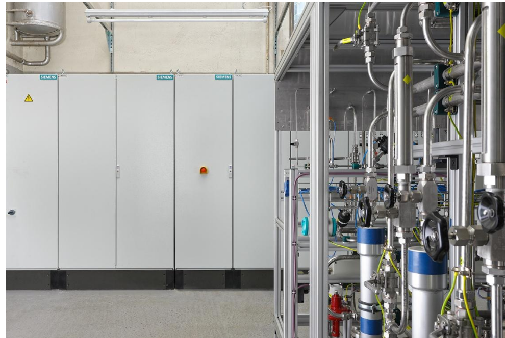
Quelle: Siemens AG
